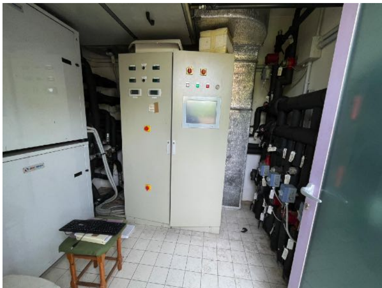
Centrale termica comune (piano terra)
